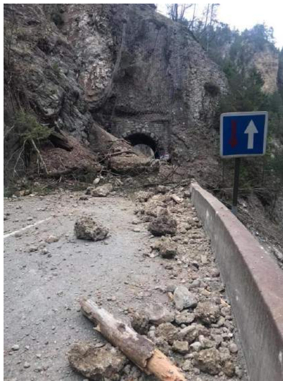
Le dernier éboulement au tunnel de Bioge
